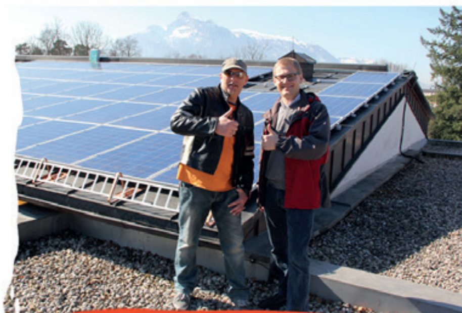
Harald Brengel und Harald Pöckl nach der Installation der neuen Solaranlage in der ÖJAB-SWA Aigen im Jahr 2014.
